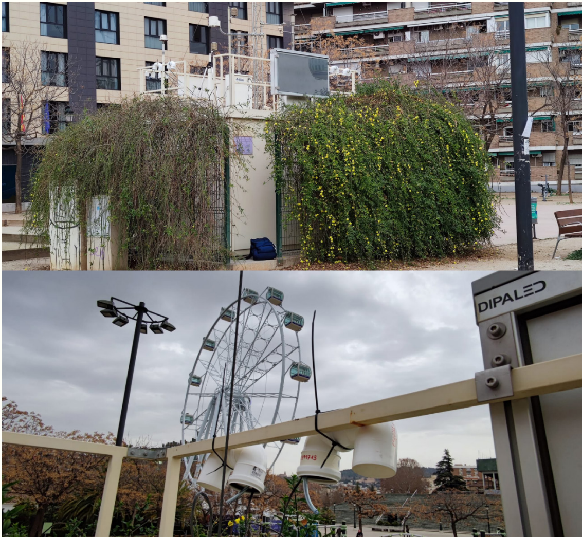
Figura 4. Calibración de sensores en la estación de monitorización de calidad del aire de la RVCCA de la Junta de Andalucía junto al Palacio de Congresos (febrero 2024).
